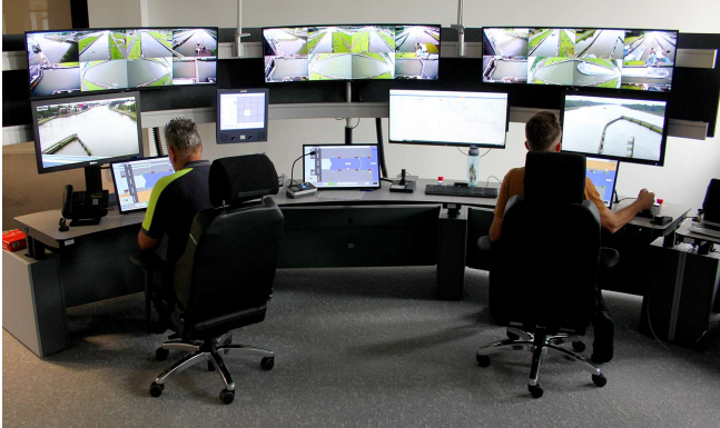
Centre de contrôle à distance de Hasselt (Flandres)
