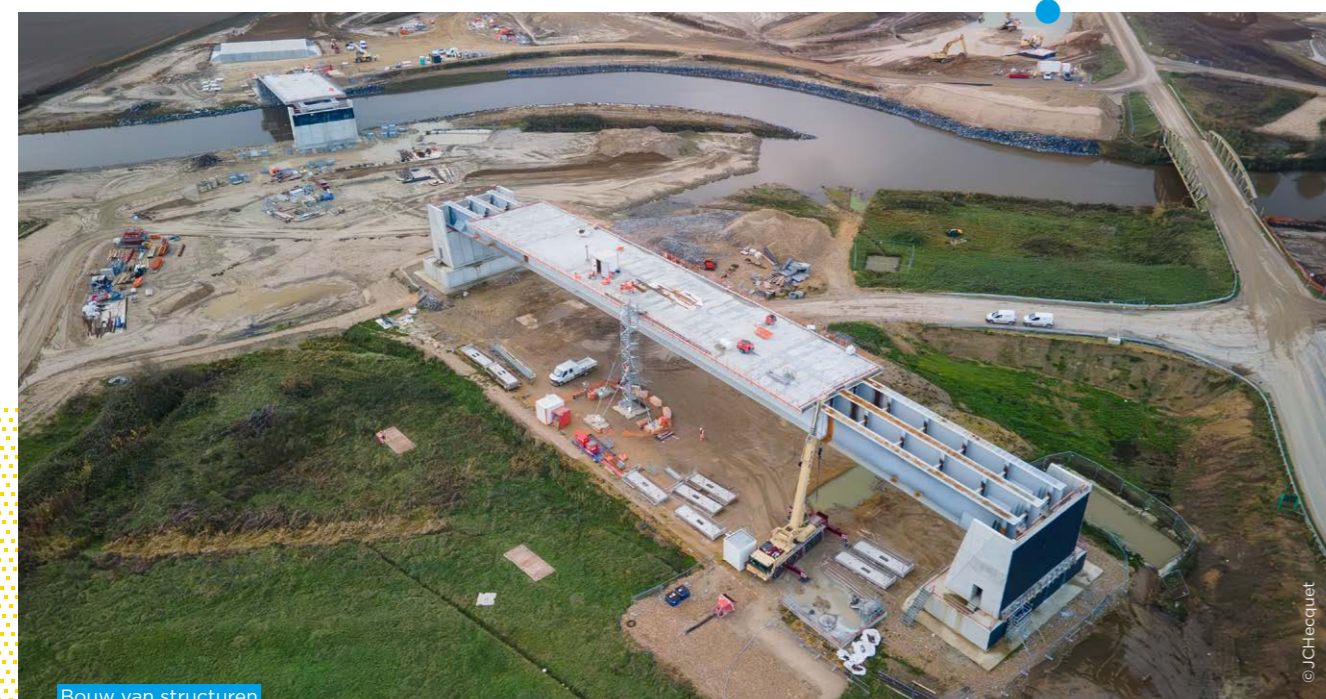
Bouw van structuren in het kader van de afsplitsing van de Oise
